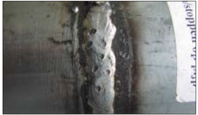
Putcorrosie in een (slechte) las in rvs buiswerk.
