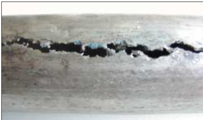
Scheurvorming in een rvs-buis door corrosie cracking stress (scc).
