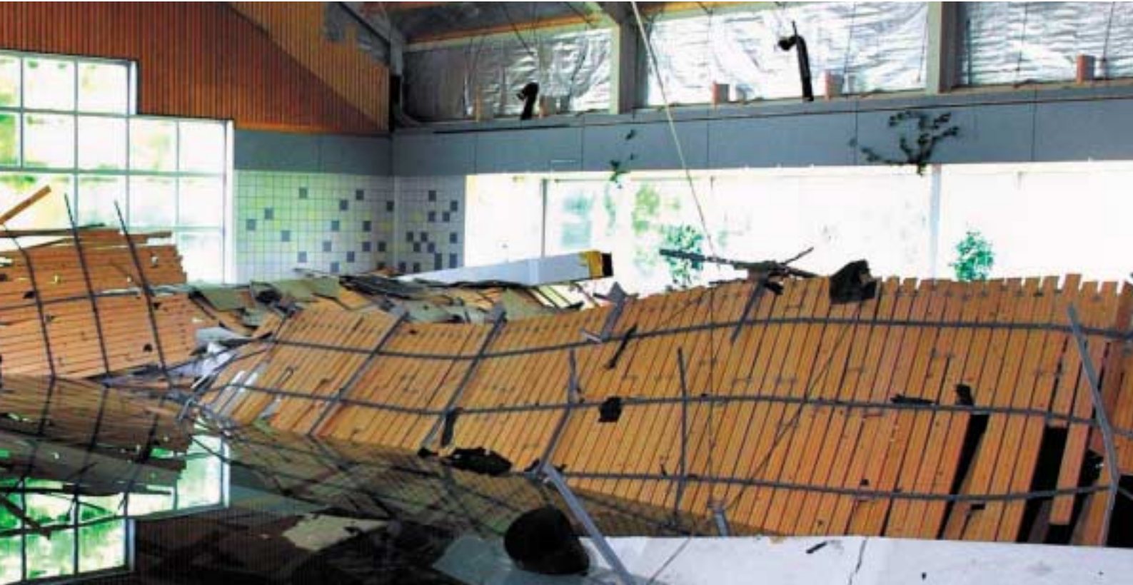
Ingestort plafond in zwembad de Waterwijk te Steenwijk. (Foto: ANP)
