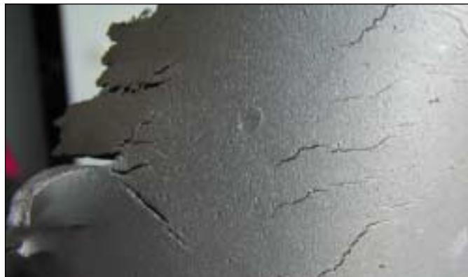
scc in een bezweken rvs leiding in een machinekamer nabij een daar opgestelde doseringsinstallatie voor chloorbleekloog.
