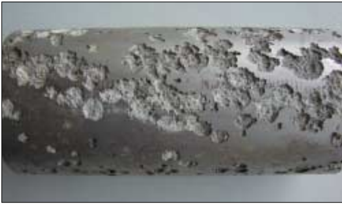
Putcorrosie in een rvs railingbuis.
