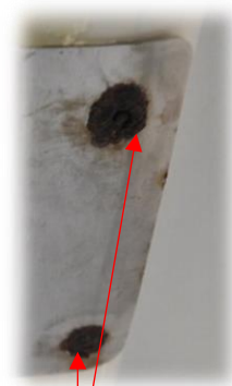
3) Galvanische corrosie stalen schroefjes
