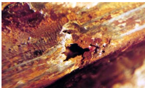
Voorbeeld van schade van toevoer waterleiding RvS type 316L met een diameter van bijna 1 meter van een grote brouwerij.
