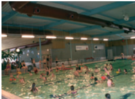
Lucht- en lichtinstallaties in zwembaden kunnen leiden tot gevaarlijke situaties.
