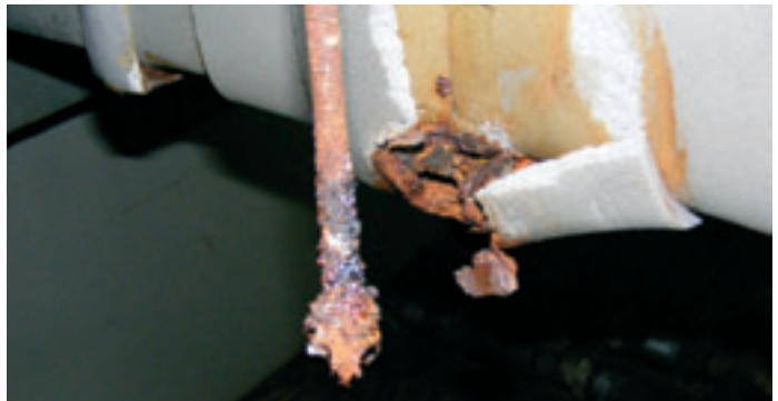
Recent onderzocht Jaap van Duijn de ophanging van een geïsoleerd buitenluchtaanzuigkanaal in een zwembad. Hierbij was de ophanging meegeïsoleerd en aan het zicht onttrokken. De ongunstige combinatie koude buitenlucht en chloordampen had de draadeinden zodanig aangetast dat deze op enkele plaatsen geheel van de ophanging zijn los geroest.
