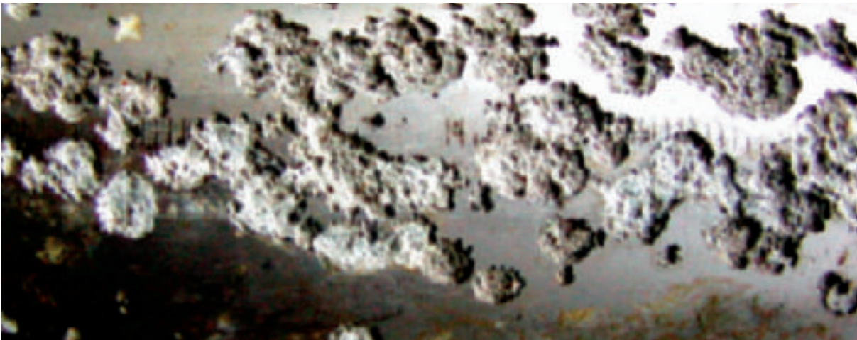
Putcorrosie op vervuilde leiding
