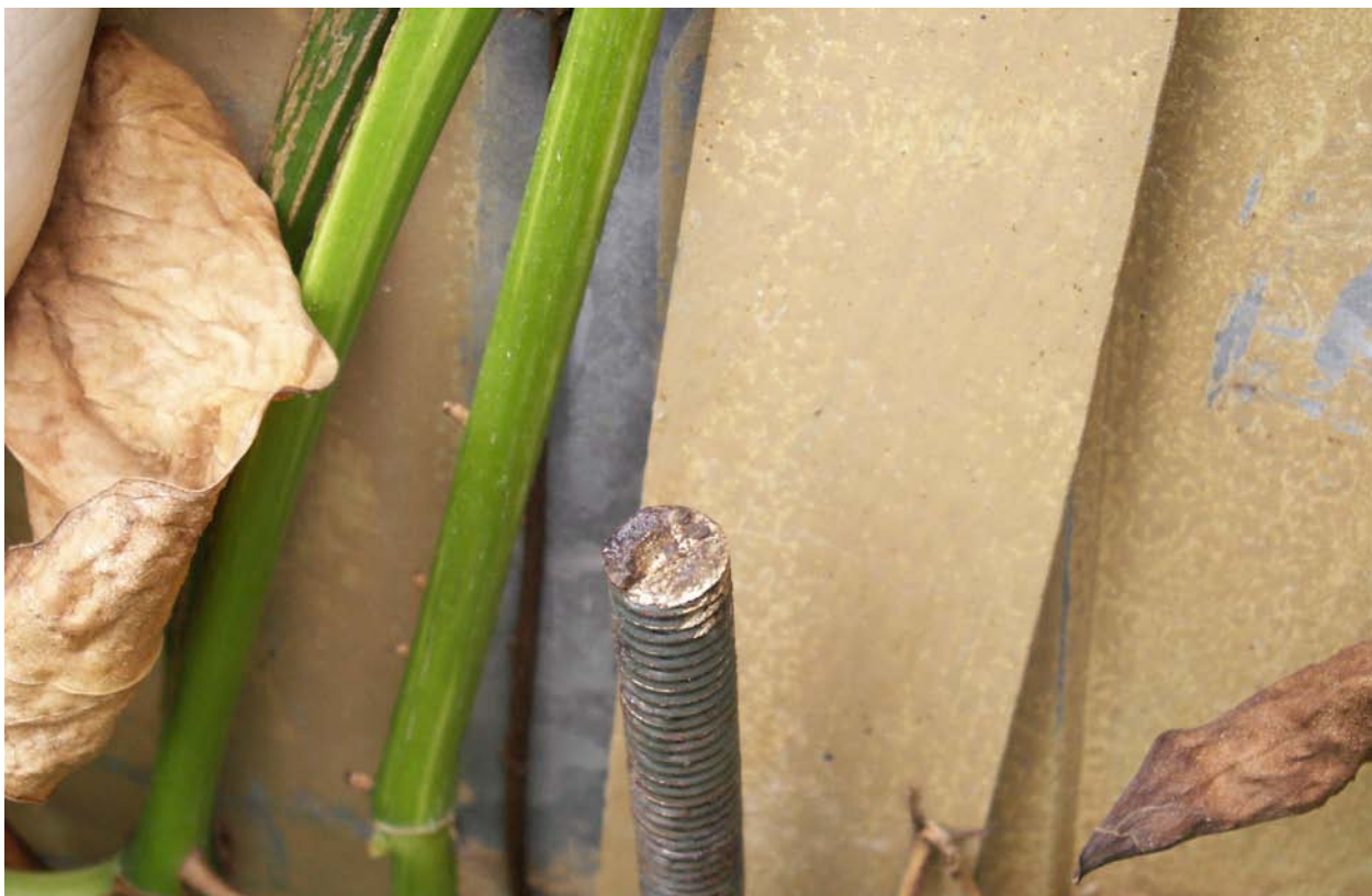
Draadeind van ophanging ventilatiekoker reeds afgebroken
