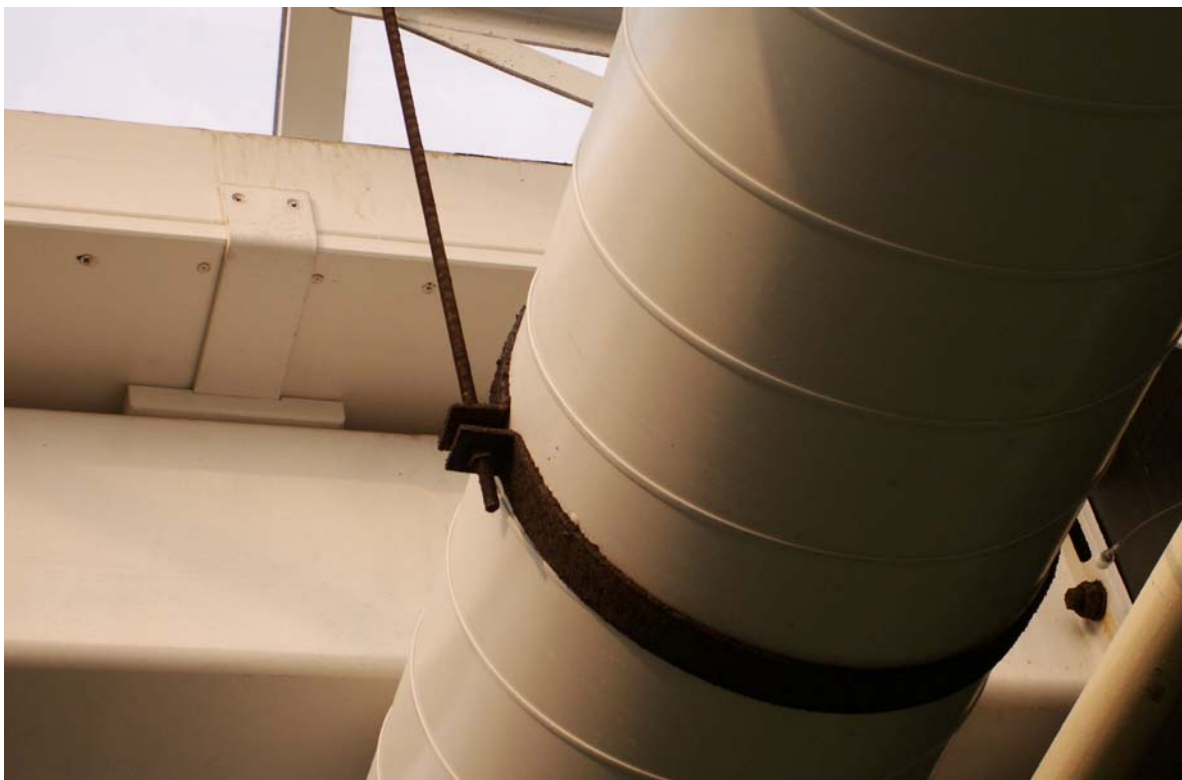
Roestvaststalen ophanging van luchtkoker + Roestvaststalen bouten in constructie
