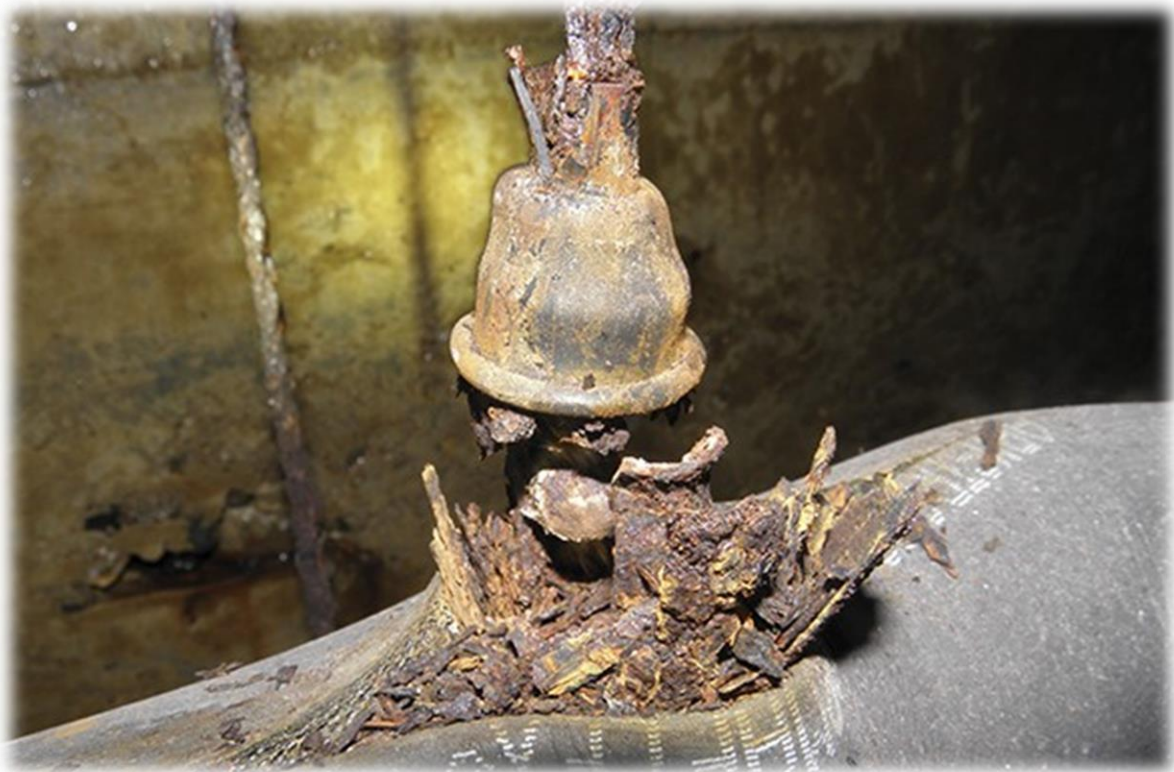
Stalen installatiedelen bevestigingen cv leidingen breken door corrosie in vochtige ruimten.
