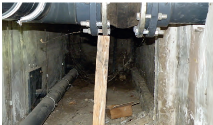
Als het latje onder de zware pvc-buis in de kelder breekt, verdrink je als je daar op dat moment aan het werk bent.
