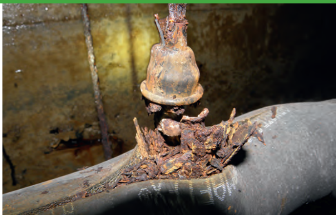
Stalen ophangbevestigingsleiding gebroken door corrosie.
