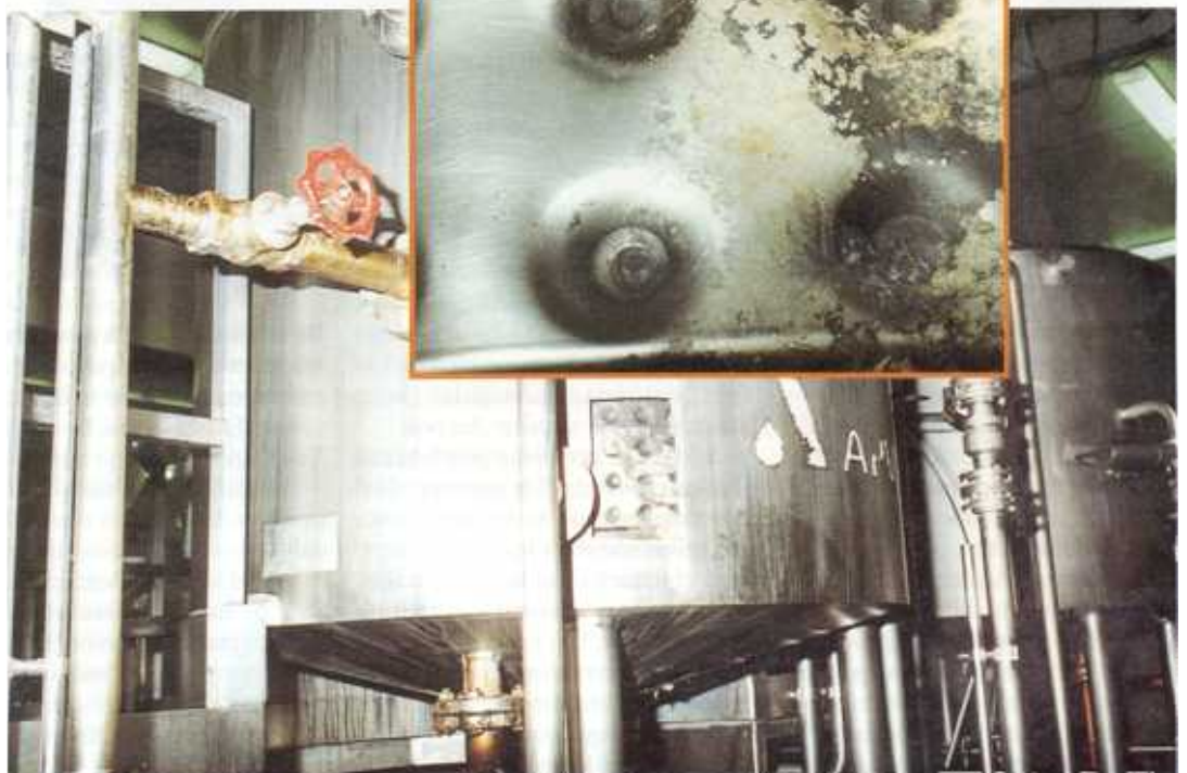
1. Deze dubbelwandige tank was rijp voor de schroothoop toen bleek dat de 'template' (dubbele rvs-beplating) was aangetast door spanningscorrosie onder de isolatie. Op de inzet is nog net de scheur door spanningscorrosie te zien. De tanks zijn inmiddels vernieuwd en voorzien van een goede coating.
