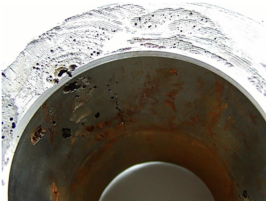
Putcorrosie in een AISI 316 roestvaststalen leiding van een 80°C brouwatertank
